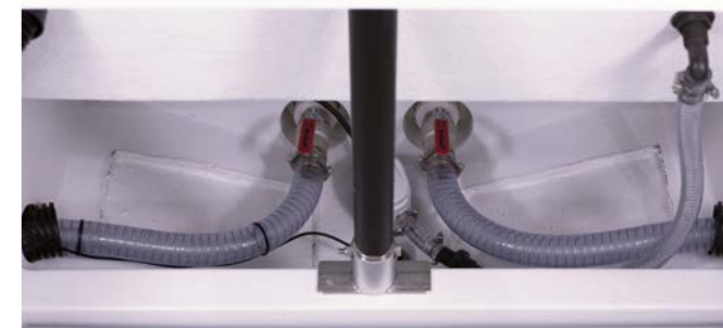
Sittbrunnens självdränering, med backventiler, leds ut längst ner i akterspegeln. Den automatiska länspumpen är placerad mellan backventilerna och utflödet pumpas ut i motorbrunnen, i bildens övre högra hörn.
