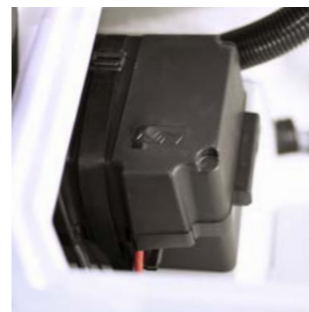
Batteriet är placerat under aktersoffan på styrbords sida.
