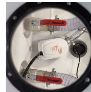
Backventilerna till sittbrunnens självdränering nås via inspektionsluckan i motorbrunnen.
